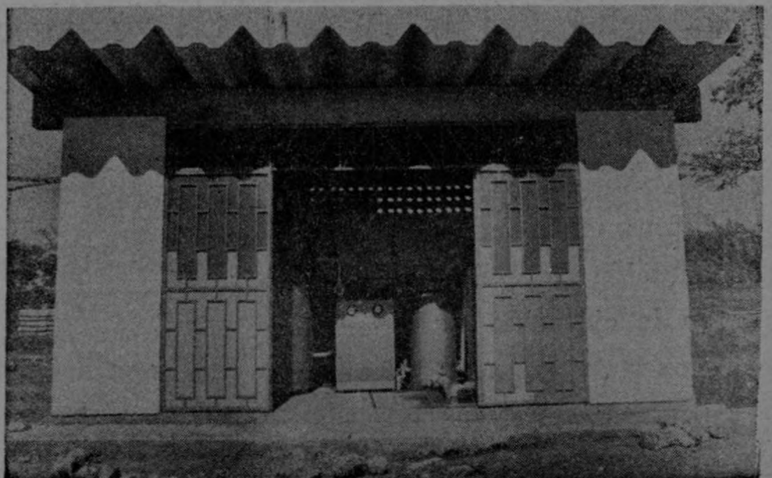
Casa de Máquinas. Este servicio permitirá mantener la presión constante en los sistemas de agua fría y caliente, y esta última a una temperatura adecuada para hacer uso directo.
